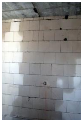
Obr. 1 Silné zavlhčení vápenopískového zdiva
