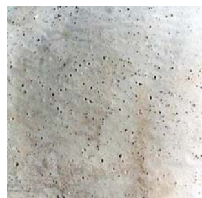
Vzduchové póry v podkladu
