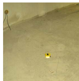
Sanace praskliny lepením a sponkováním
