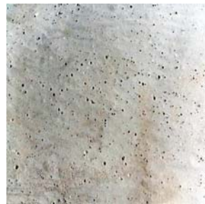
Vzduchové póry v podkladu
